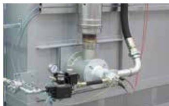
Подвод газа на боковой стороне печи
